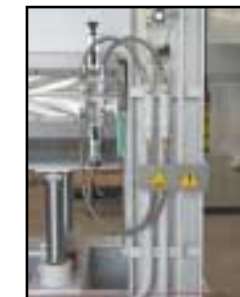
Impianto di riscaldamento Heating system Heizkreisanschlüsse
